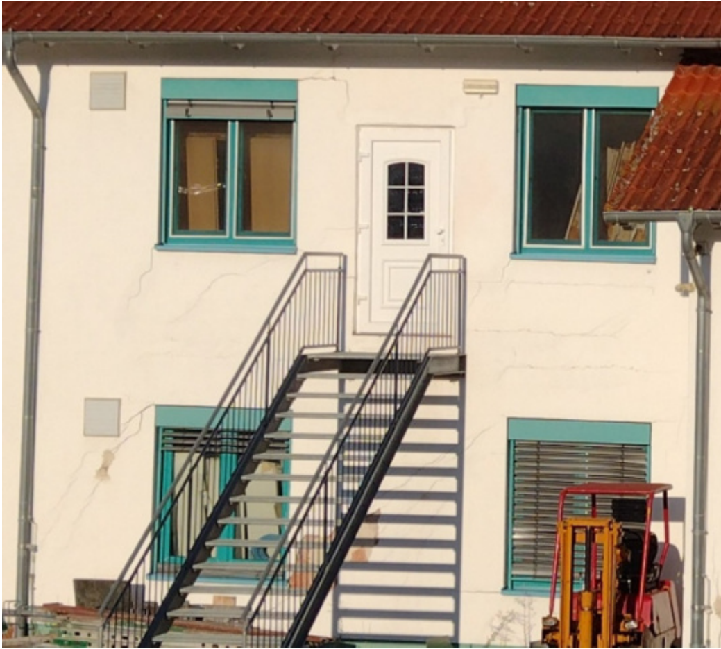
Die Fassade des Ostflügels weist in Teilen eine deutliche Rissbildung auf
